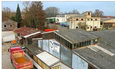
Viele vermietete Gebäude auf dem Weinzierl-Areal sind marode, die Sanierung lohne nicht, sagt die Stadtverwaltung. Foto: Eberl (Archiv)
